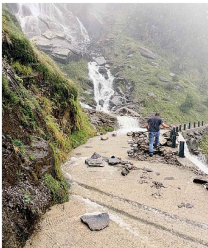
Carona, una valletta fuoriuscita sulla strada che porta al rifugio Longo
